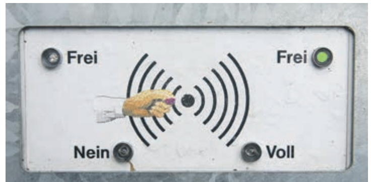
Dieser Zugangssensor für die Müllschleuse ermöglicht die haushaltsbezogene Abfallerfassung.
